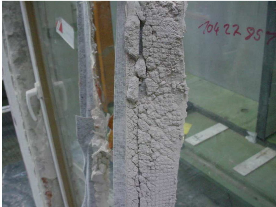
Bild 7 Abschließende Untersuchung des Anschlussbereiches. Raumseitige Folie nach entfernen des Leibungsputzes.
