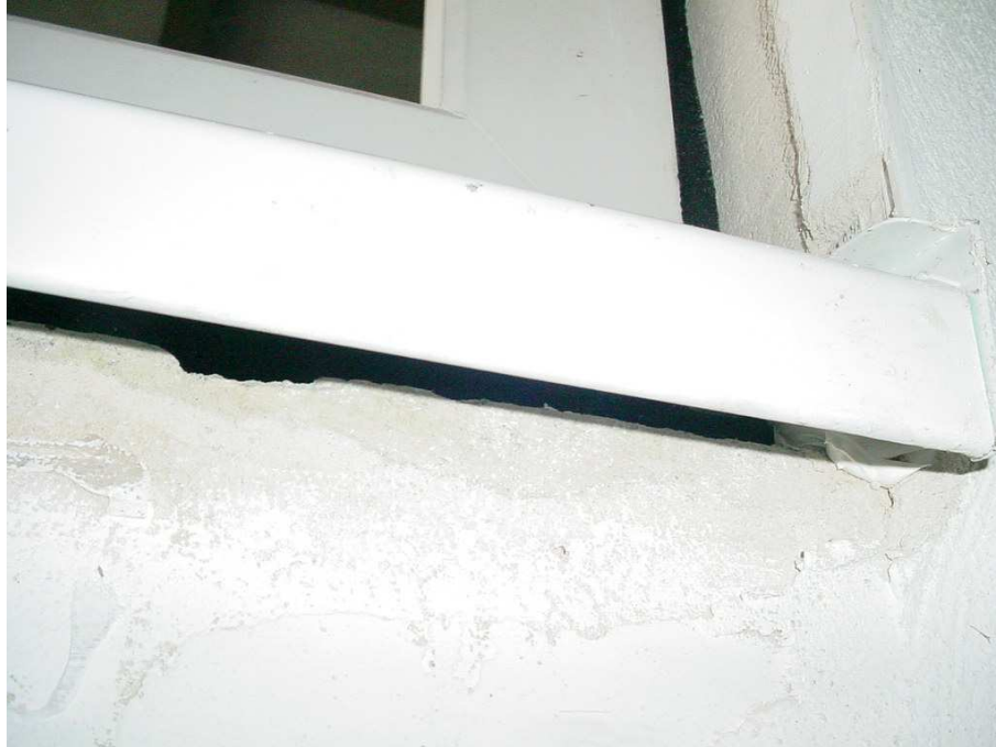
Bild 5 Außenseitige Abdichtung unterer Bereich, Fensterbank montiert (Ausführung für die Untersuchung der Schalldämmung)
